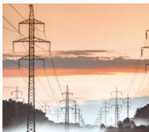
Levantamento de instalações de energia
